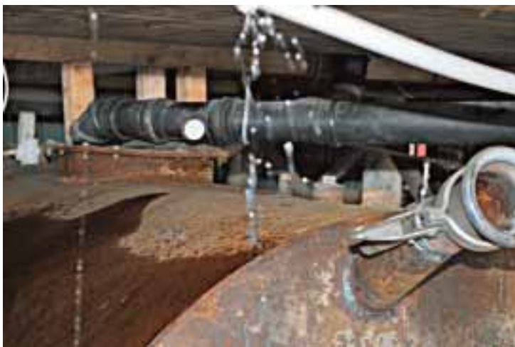
KOBLINGEN: Slik er kloakkrørene koblet til septiktanken.
